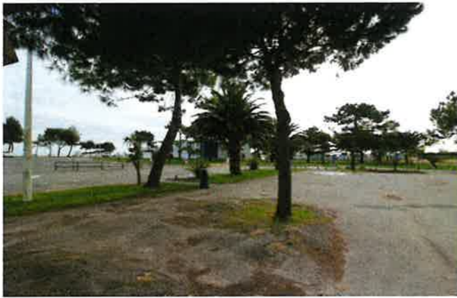
6 - Parking central : déformation du revêtement par les racines des pins
